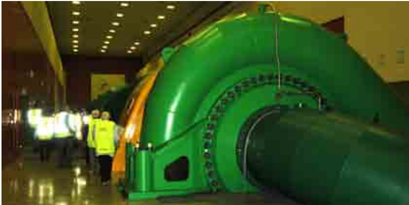
Dans la centrale 2 (pompage-turbinage) sous le lac de retenue: l'une des 4 machines pouvant être utilisées comme pompes ou comme générateurs.
